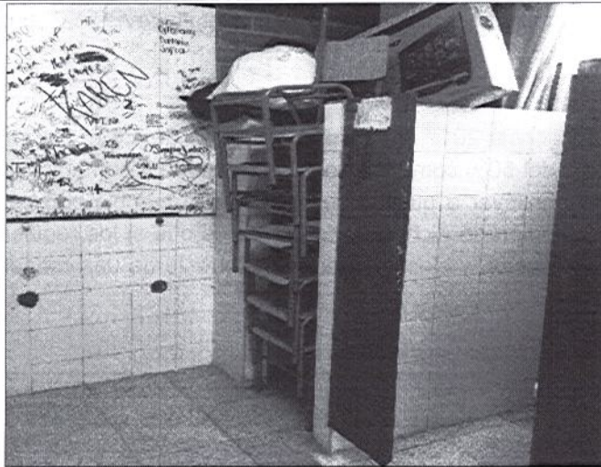
Baños niños donde se encuentran ubicadas sillas a dar de baja y a reparar
