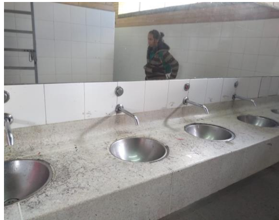
Imagen No.1. Sistemas ahorradores lavamanos y baños
