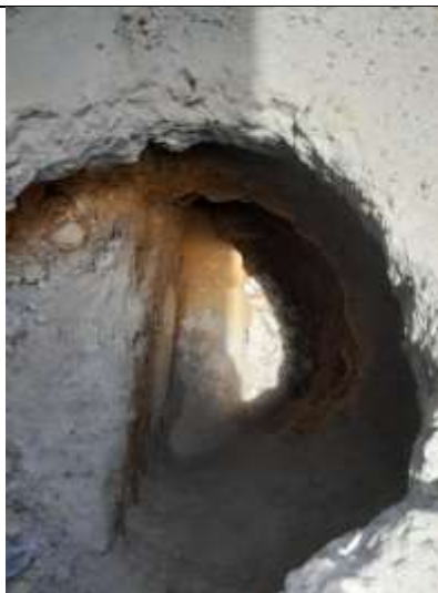
Fotografía 6. Acometida de agua potable al interior del Col. Alfredo Iriarte (IED), sede B, El Mirador. Localidad de Rafael Uribe Uribe.
