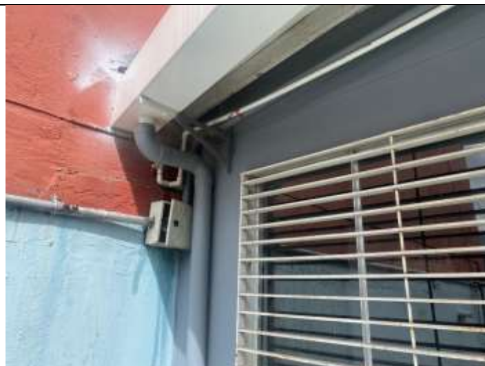
Fotografía 4. Presencia de agua potable en la derivación de la nueva red de suministro de agua potable al interior del Col. Alfredo Iriarte (IED), sede B, El Mirador. Localidad de Rafael Uribe Uribe.
