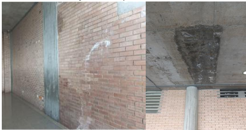
Imagen 5. Paredes y techo con humedad
