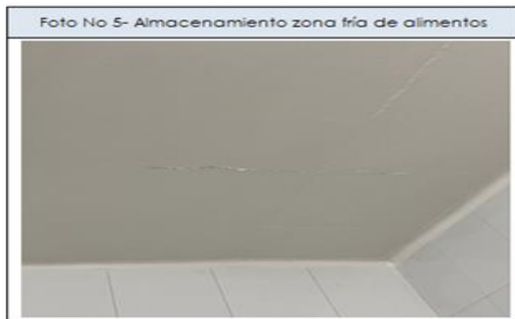
Fuente: Visita Colegio Carlos Pizarro - Techo agrietado
