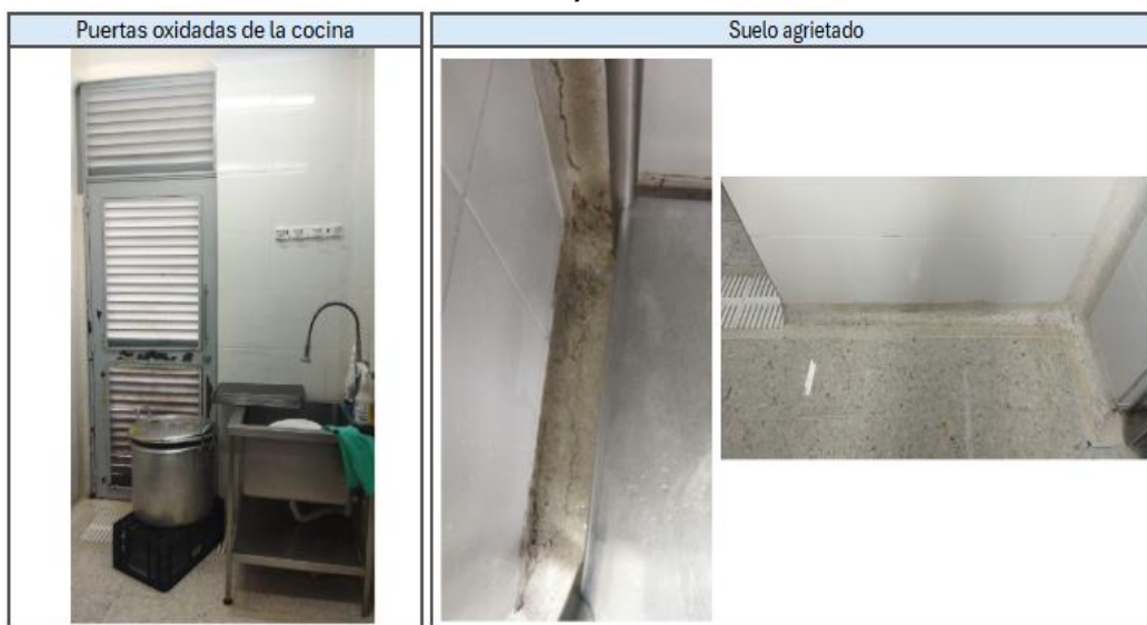
Foto No 4- 5 Puertas y suelo en mal estado
