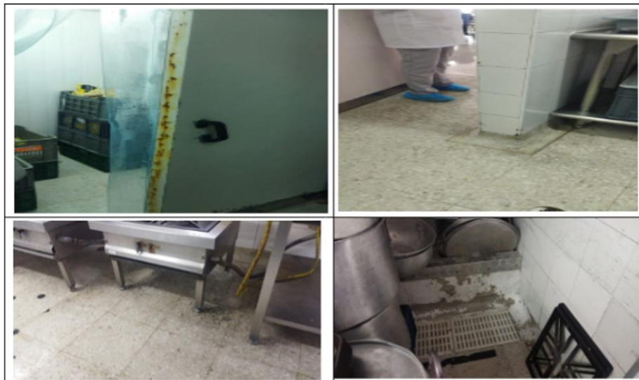
Fotografías No1-2-3-4 Puerta Oxidada – Deterioro Infraestructura
