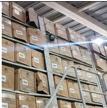
Foto No. 8 Instalación de datalogger
